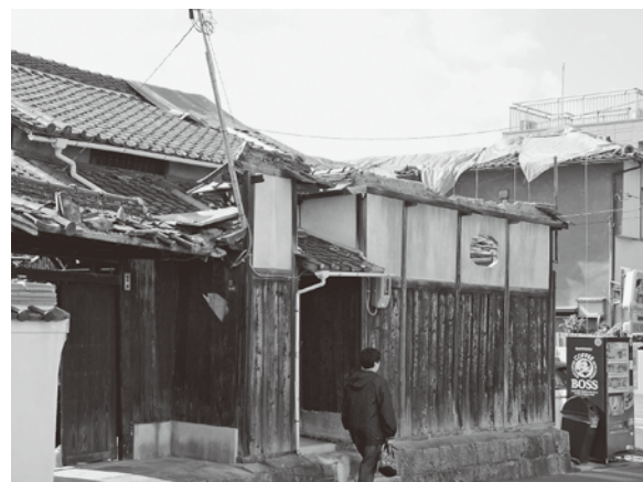
ブルーシートがかかったままの住宅(大阪市中央区)
